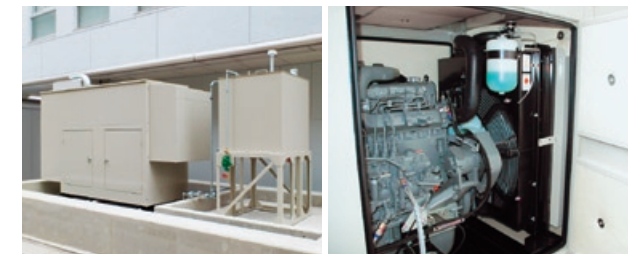
(自家発電装置 左：外観 右：エンジン部)
